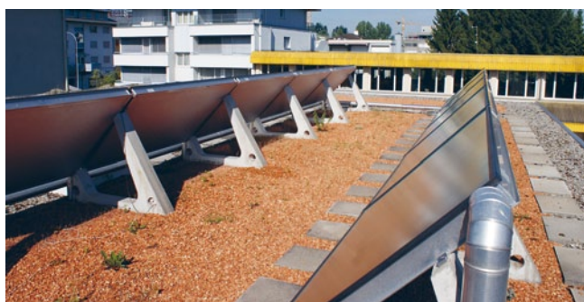
Sonnenkollektoren auf Betonaufständung montiert. Gehwegplatten schützen das Abdichtungssystem bei Wartungs- und Unterhaltsarbeiten an den Modulen.
